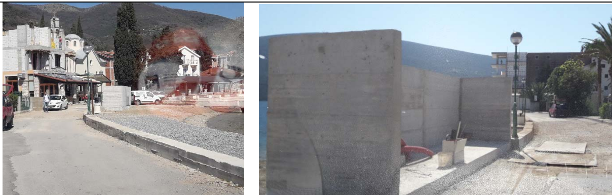
Lokacija generatora PS Djenovići – uz saobraćajnicu
